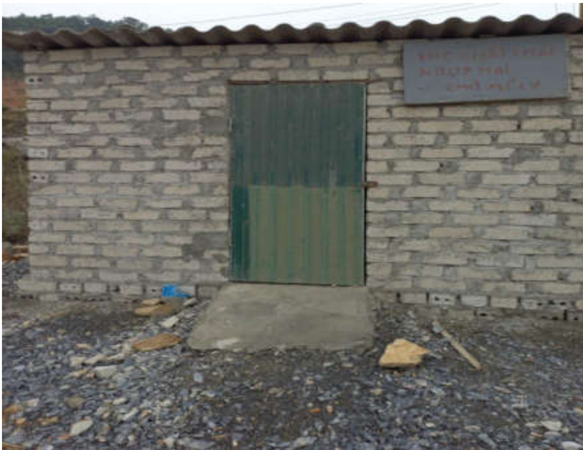
Hình 3.11. Hình ảnh kho chứa chất thải nguy hại tại mỏ
